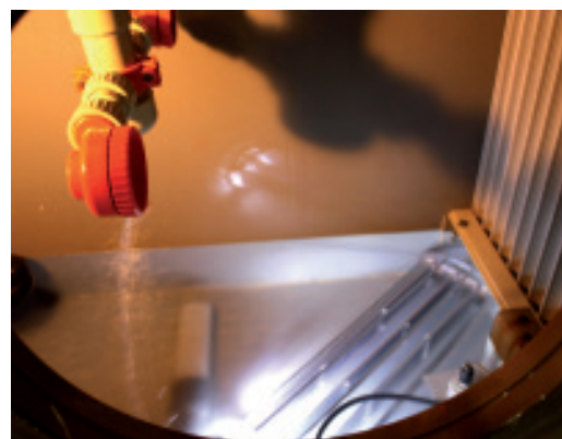
Рис. 3 Циркуляционный распыляющий увлажнитель воздуха — вид изнутри, распылительные форсунки
